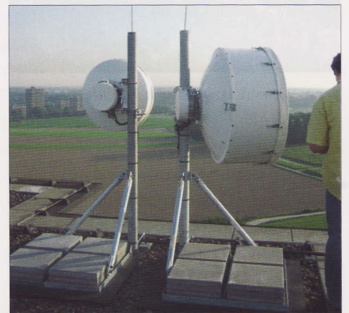
Richtfunk verbindet Verwaltungsstandorte.
